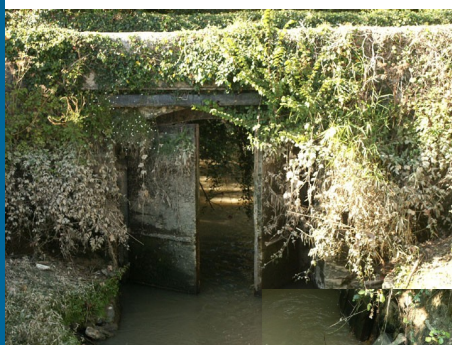
Porte à flots (au dessus) et à clapet (à droite)
